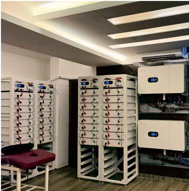
Мексика ➤➤ Готель ➤➤ 100 кВт+163,84 кВт·год
