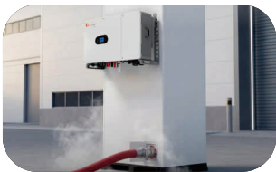
Зовнішній вхід для пожежогасіння водою
