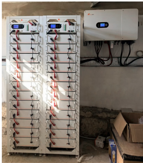
Německo Malá továrna 50 kW+122,88 kWh
