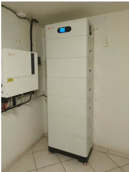
Švédsko Dům 20 kW+30 kWh
