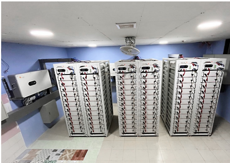
Thajsko Zábavní centrum 300 kW+720 kWh
