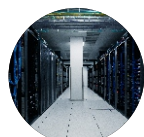
Základnové komunikační stanice
