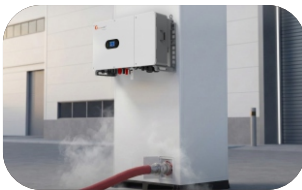
Externí přívod vody pro hašení požáru
