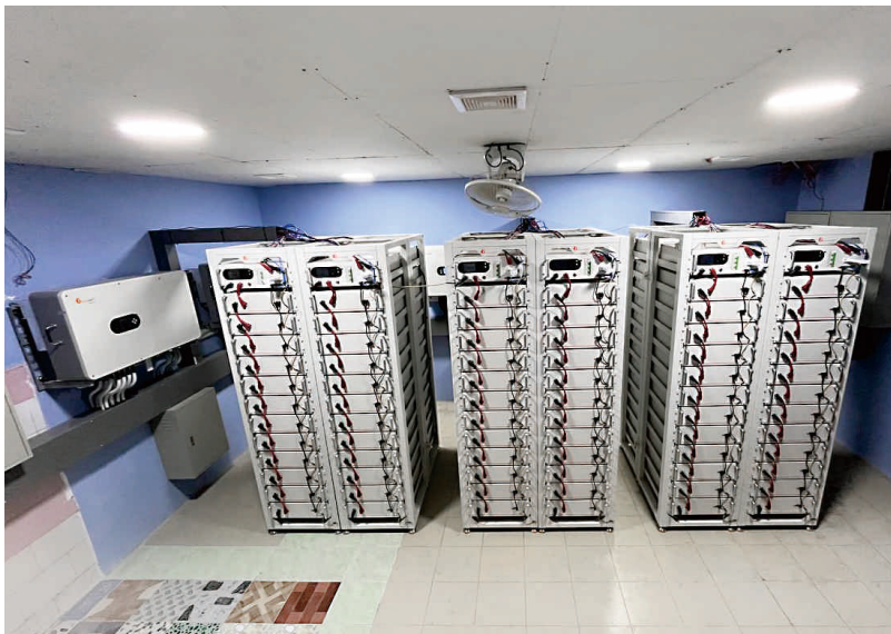
Tailanda Centru de divertisment 300 kW+720 kWh
