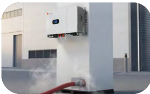
Raccordement externe pour l'alimentation en eau d'extinction
