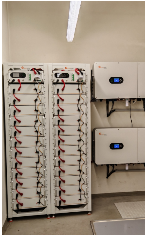
Polen Magazijn & Kantoor 100 kW+122,88 kWh
