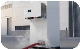
Externe waterinlaat voor brandbestrijding
