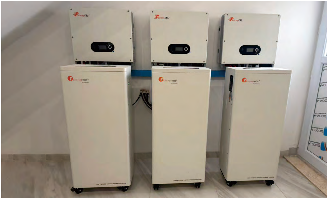
Arábia Saudita Casa 15kW+45kWh
