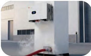
Entrada externa de água para combate a incêndios
