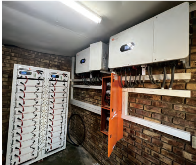
África do Sul ➤➤ Loja de ferragens ➤➤ 100kW+122.88kWh
