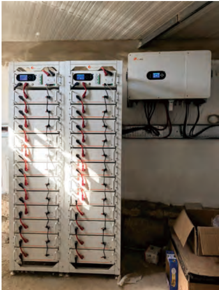
Nigéria Fábrica de pequeno porte ➤➤ 50kW+122.88kWh
