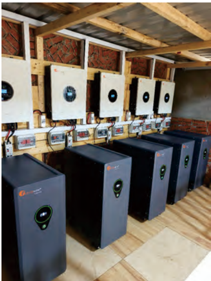
Senegal Prédio de escritórios 40kW+125kWh
