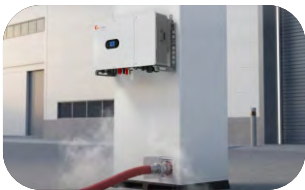
Entrada de agua externa para extinción de incendios
