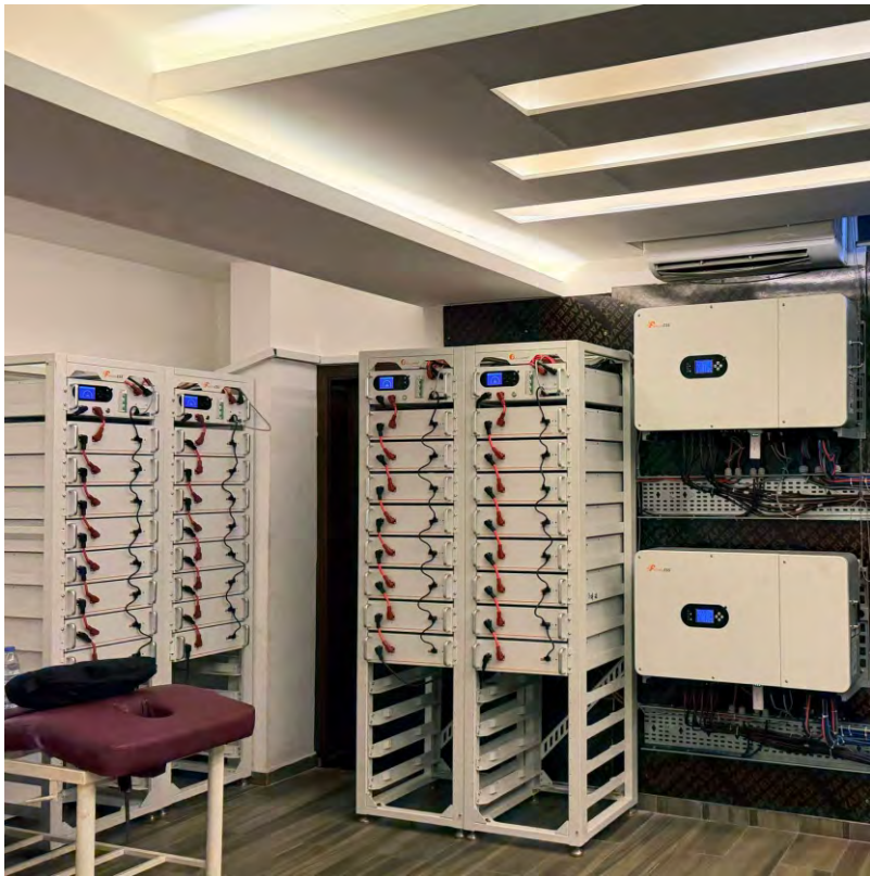
México » Hotel » 100 kW + 163,84 kWh
