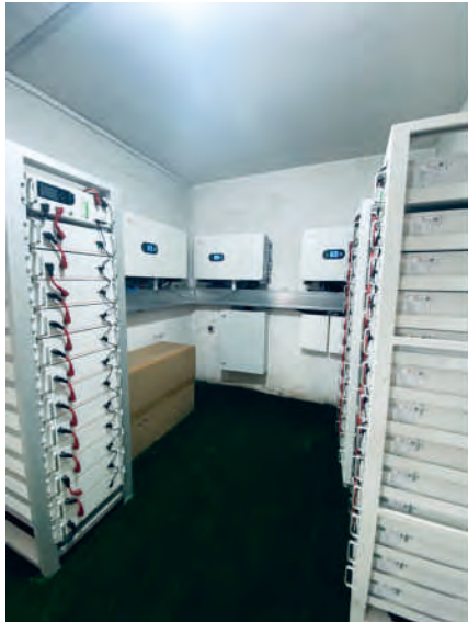
Mali Nhà máy giấy ➤ 150kW+184,32kWh
