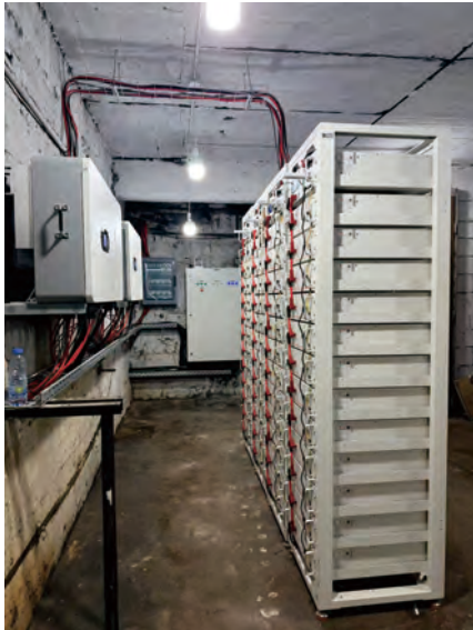
Iraq Nhà kho ➤ 100kW+245,76kWh
