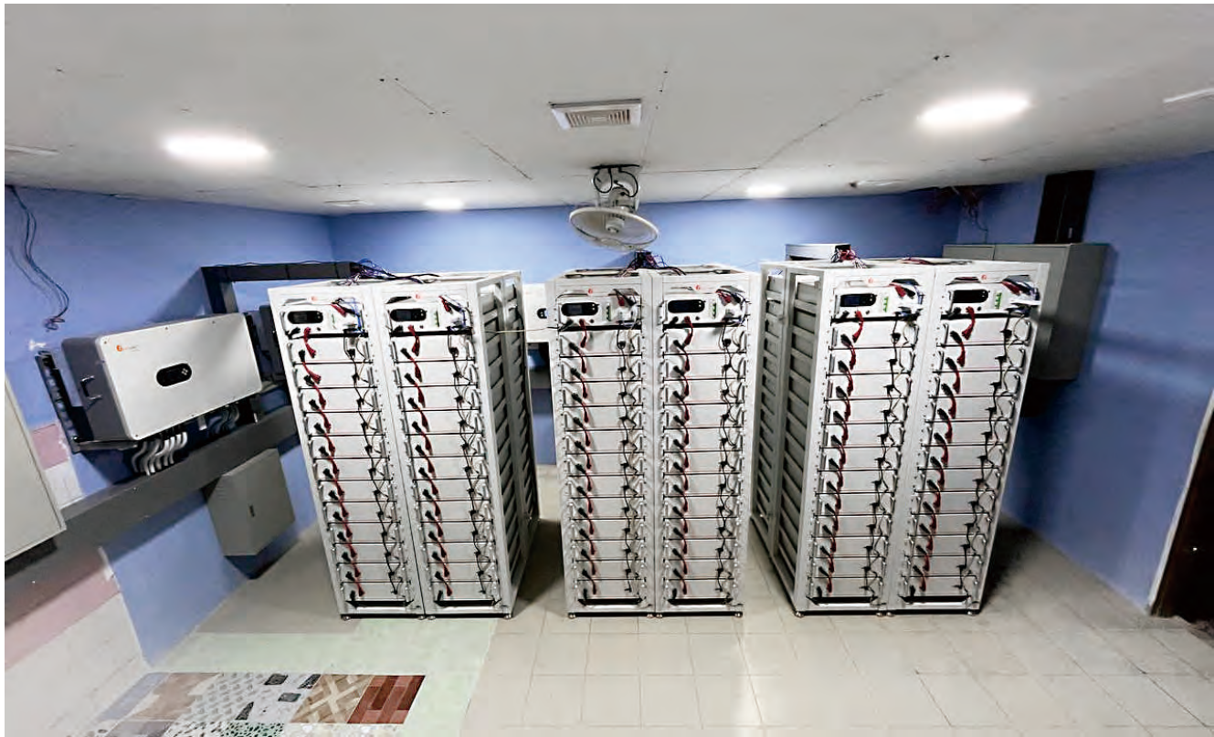
Thái Lan Trung tâm giải trí ➤ 300kW+720kWh
