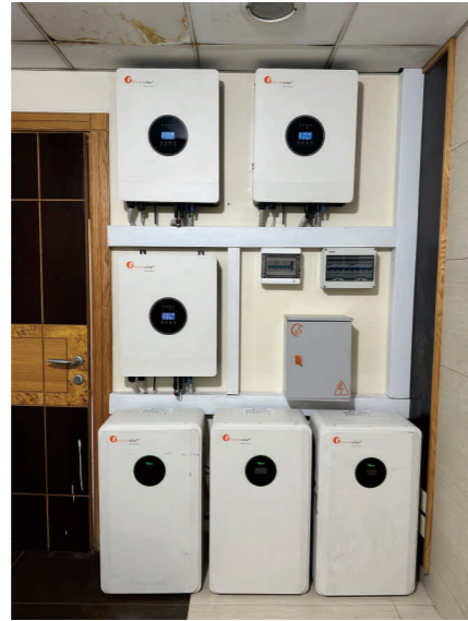
Yemen » House » 24kW+30kWh
