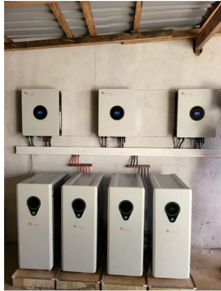
Guinea » House » 24kW+52.5kWh
