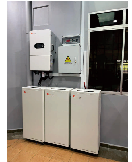
Thailand » House » 20kW+45kWh
